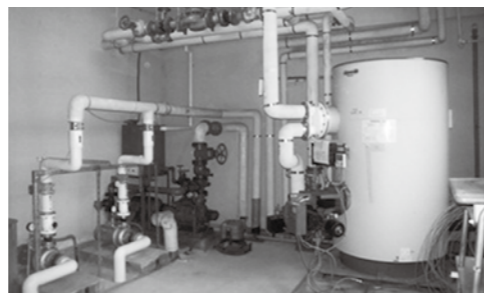
アスベストが確認されたボイラー室
