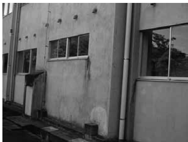
劣化した外壁
