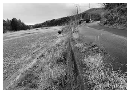
落差があり危険な箇所
